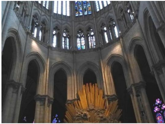
1-Travaux de mise en conformité des installations électrique, essai d'éclairage du chœur, sous maîtrise d'œuvre E. Poncelet (Cliché DRAC)
